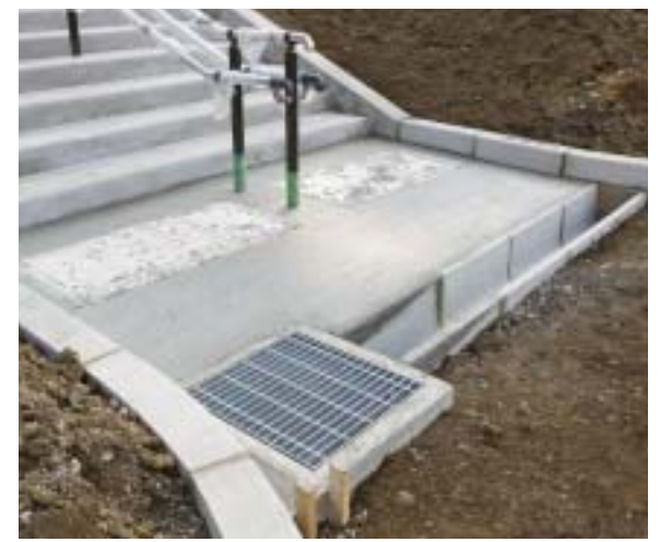
U形側溝(写真手前)として使用されているエコセメント(八王子市)
