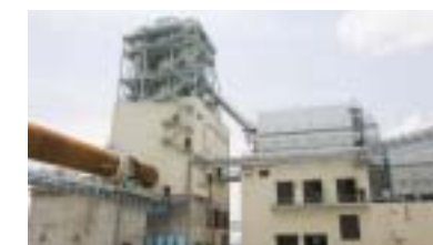
円筒形のロータリーキルン(左)と排ガス処理棟(中央)、重金属回収設備(右)
