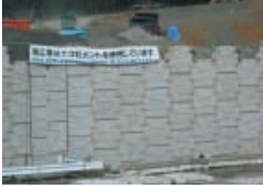
ニッ塚処分場内では、エコセメント化施設用地の造成工事が進んでいます。この工事でもエコセメントが使用されています。
