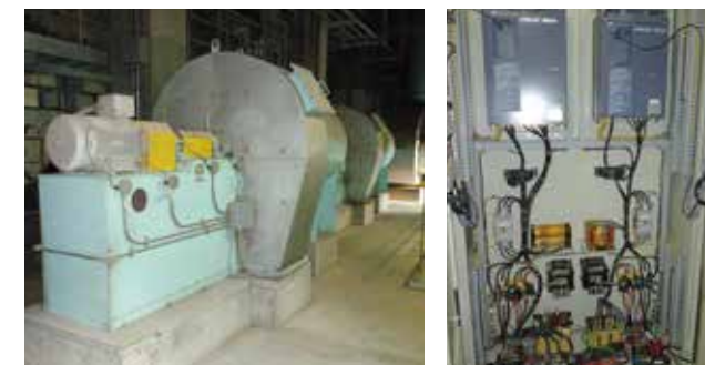
クリンカクーラ設備
