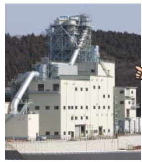
重金属を回収する設備。
